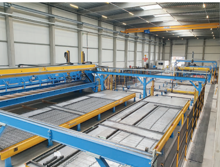
Gesamtansicht der Anlage mit automatischer Bewehrungsstahlverarbeitung sowie vollautomatisiertem Schalungsroboter einschließlich Palettenreinigungseinrichtung
