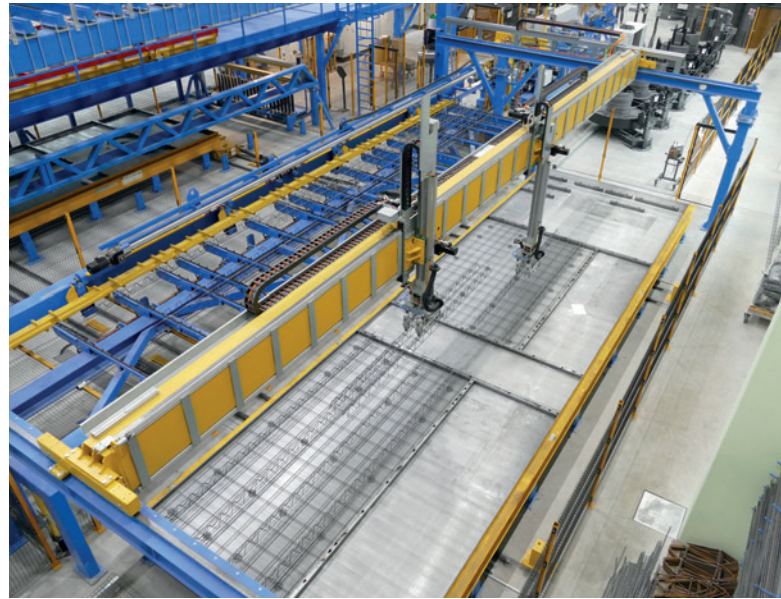
Wieloosiowy robot liniowy stanowi zwieńczenie automatyki zastosowanej w obszarze produkcji zbrojenia nowego zakładu firmy Eder.
