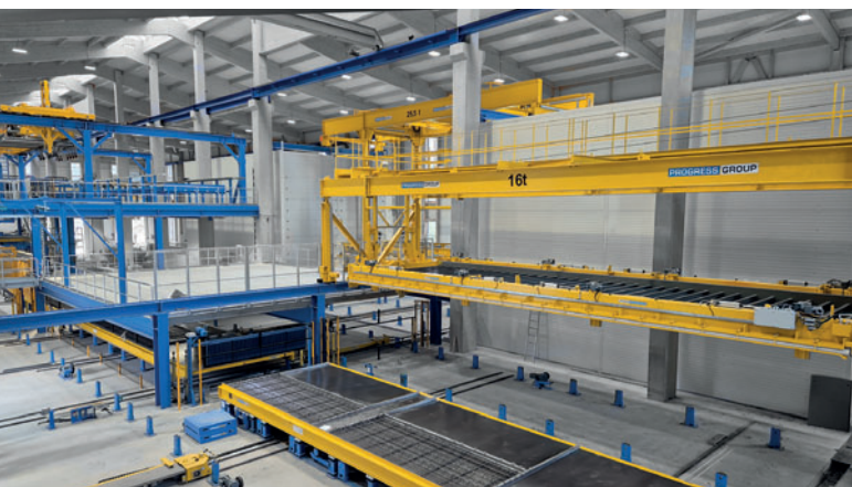
Автоматическое поворотное устройство используется при производстве двойных стеновых панелей
